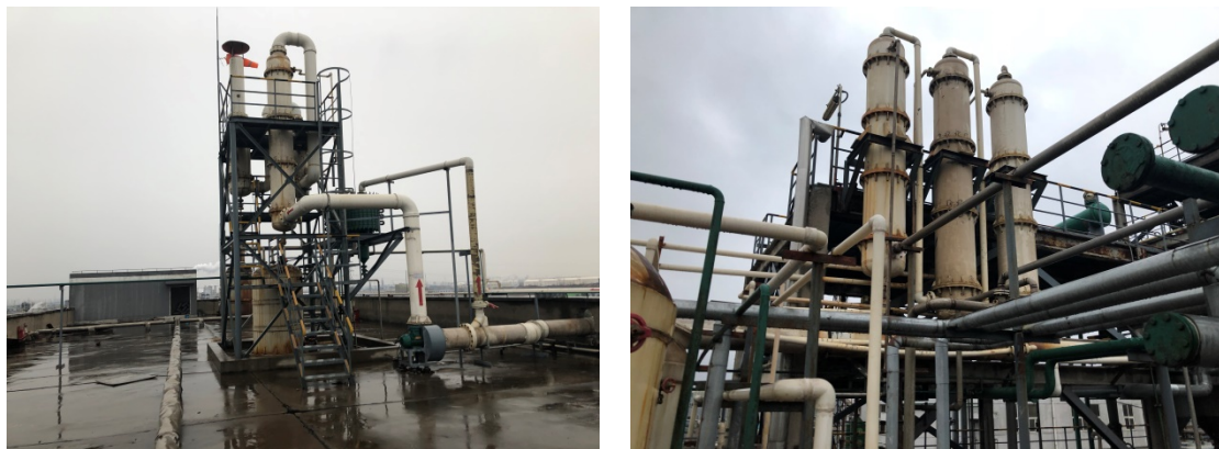
图 4.1-4 废气处理装置照片
